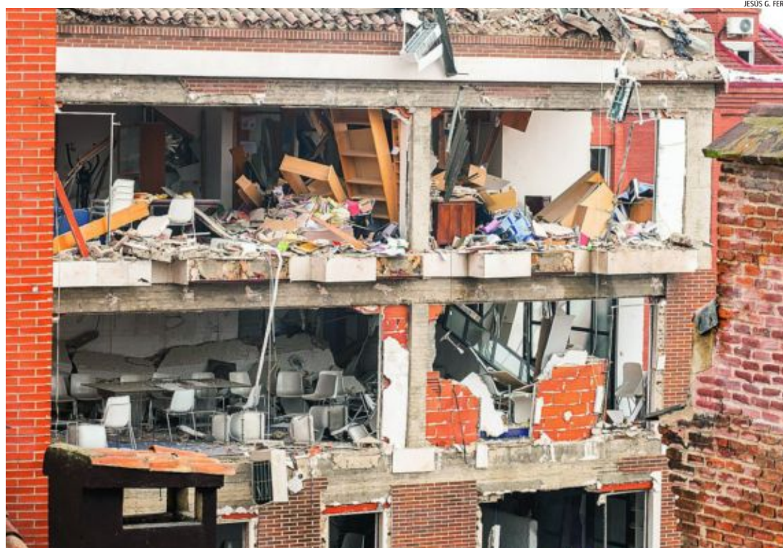
La onda expansiva reventó las tres últimas plantas del edificio y dañó inmuebles cercanos
